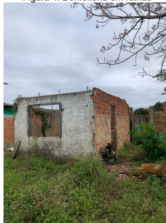
Figura 4: Benfeitoria em ruínas
