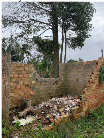
Figura 3: Benfeitoria em ruínas
