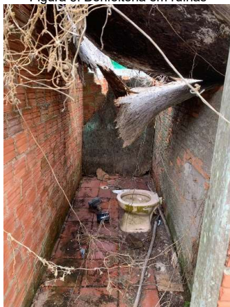
Figura 5: Benfeitoria em ruínas
