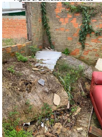
Figura 6: Benfeitoria em ruínas
