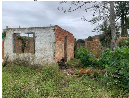
Figura 2: Benfeitoria em ruínas
