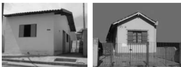
Quadro 1 – Estado de Conservação – Ec
